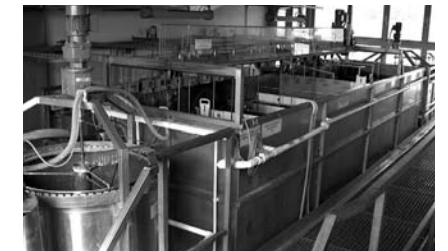
Pilotażowa oczyszczalnia ścieków zlokalizowana w Centralnej Oczyszczalni Ścieków miasta Poznania
