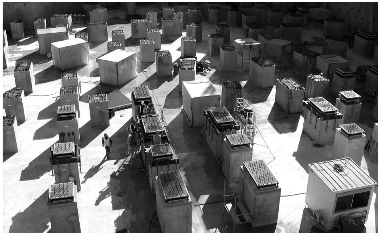
Antysejsmiczne wibroizolatory pod budynkiem reaktora jądrowego (francuski EPR).
